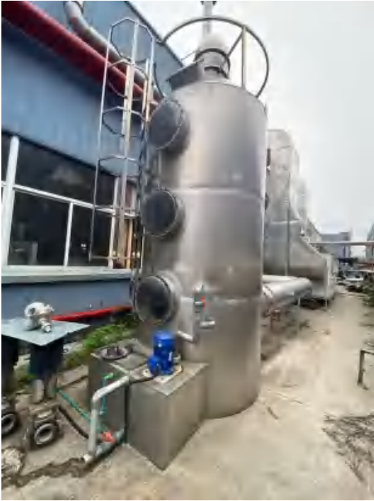
2#PVDF 膜/PES 膜/尼龙膜制膜废气/溶剂废气/蒸馏塔冷凝尾气处理设施 (水喷淋)
