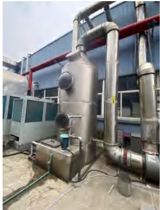
1#PVDF 膜/PES 膜/尼龙膜制膜废气/溶 剂废气/蒸馏塔冷凝尾气处理设施 (水喷淋)
