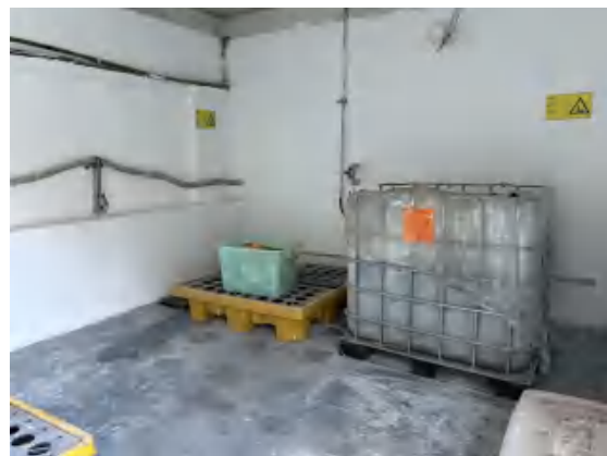
危废暂存库及标识标牌
