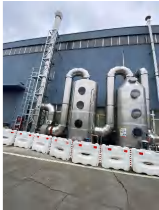
1#层析膜/中空纤维膜制膜废气处理设 施 (两级水喷淋)
