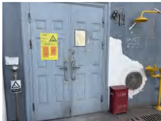
危废暂存库及标识标牌
