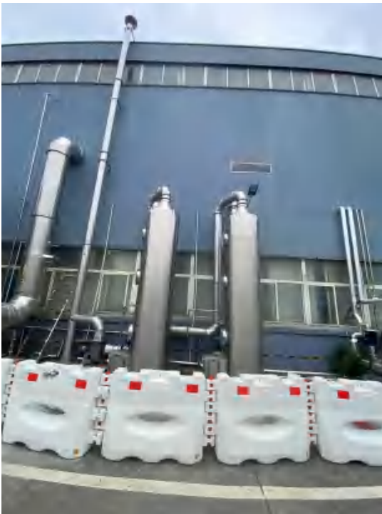
2#层析膜/中空纤维膜制膜废气处理设 施 (两级水喷淋)
