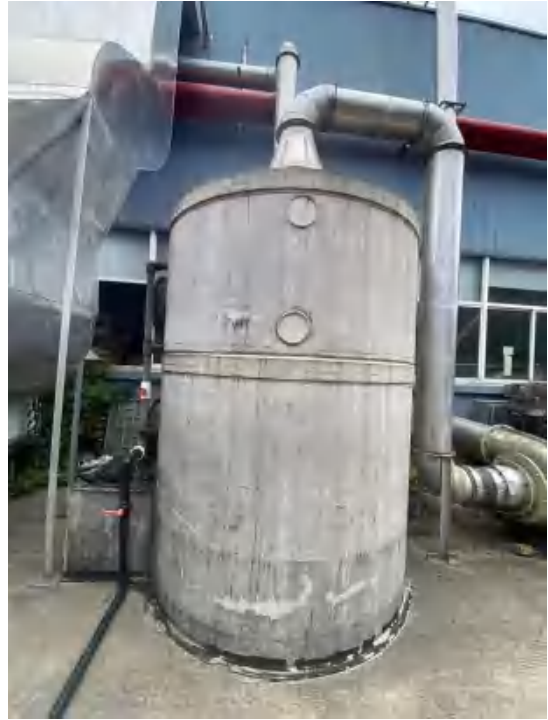
3#PVDF 膜/PES 膜/尼龙膜制膜废气/溶剂废气/蒸馏塔冷凝尾气处理设施 (水喷淋)
