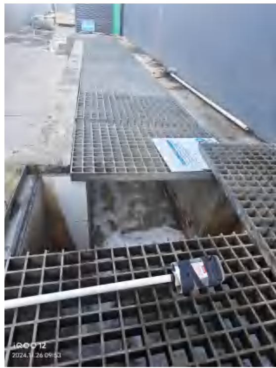
科百特 C7 厂区废水处理站（排放口）
