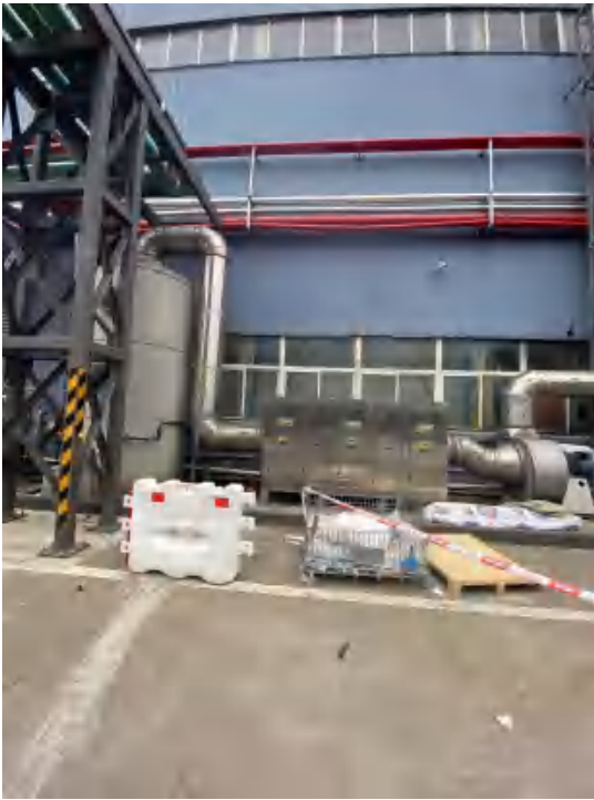
PVDF 膜/PES 膜/尼龙膜制膜废气/溶剂 废气/蒸馏塔冷凝尾气处理设施 (水喷淋+活性炭吸附)
