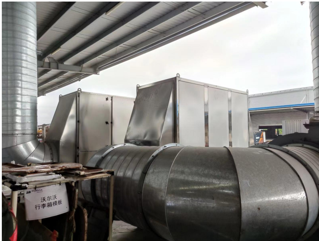
废气处理设施
